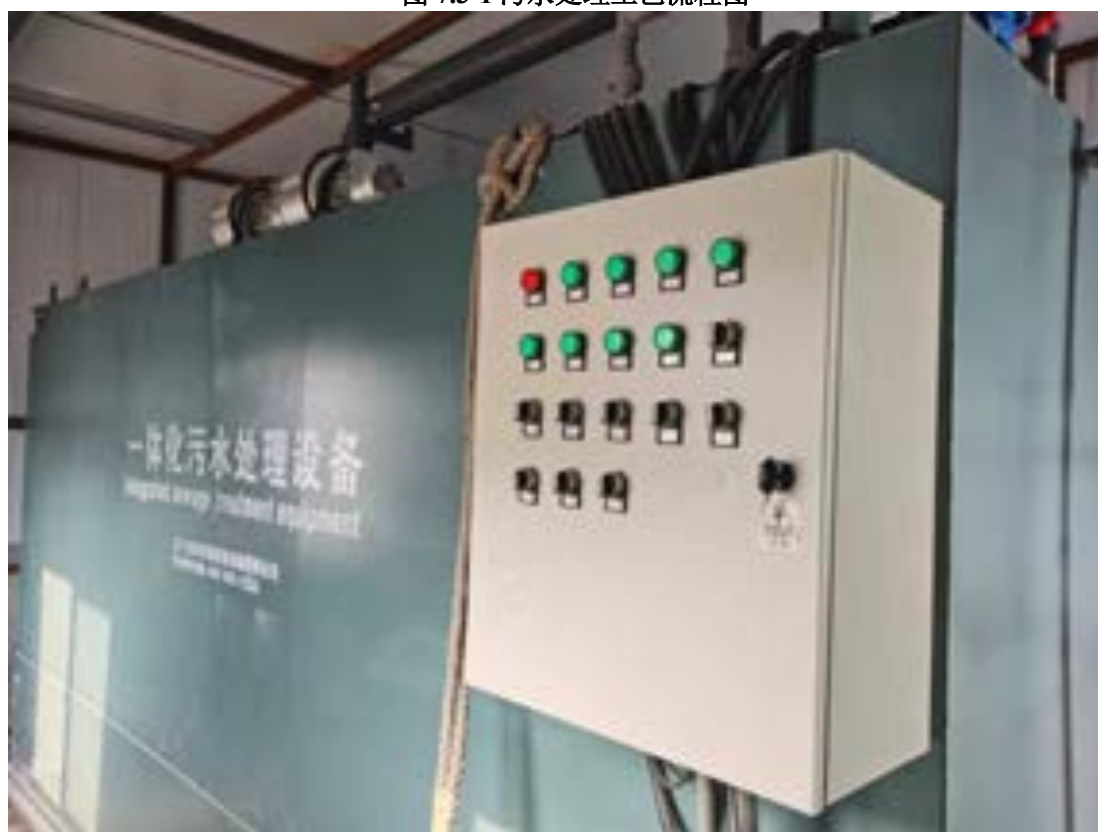
图 7.3-2 污水治理设施照片
